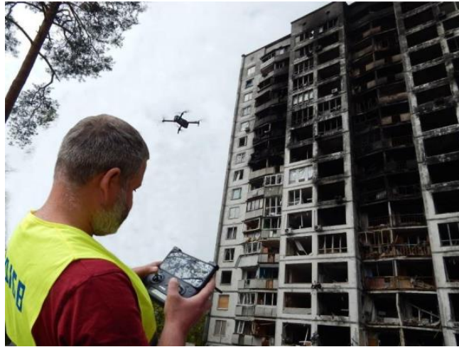
Рис. 1. Обстеження пошкоджених унаслідок воєнних дій будівель із використанням безпілотних літальних апаратів фахівцями ДП «НДІ будівельного виробництва ім. В.С. Балицького» [2].
